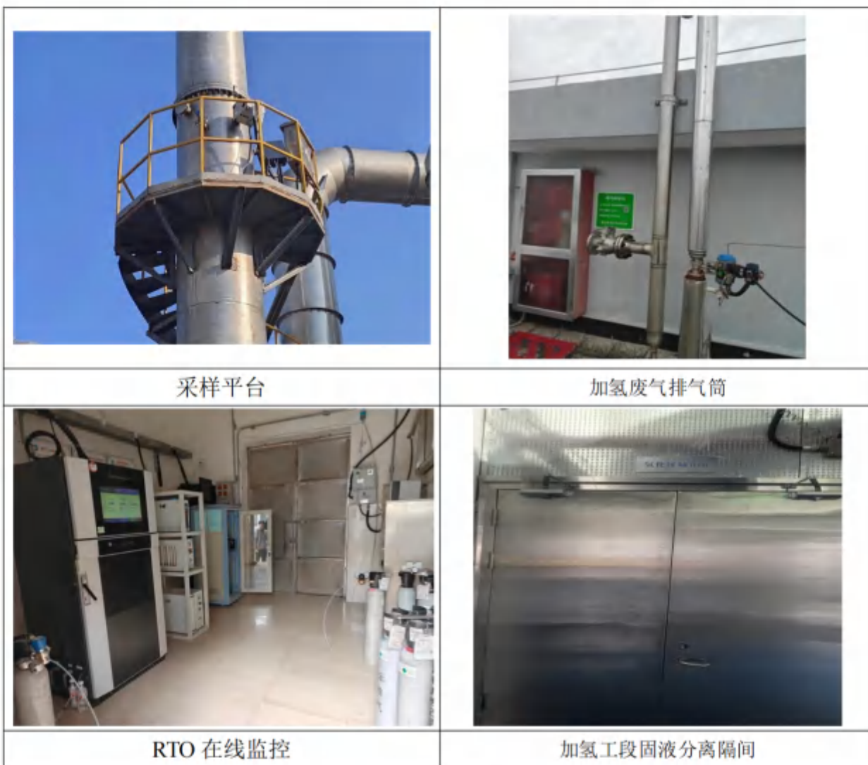
图 4.2-4 废气处理设施照片
