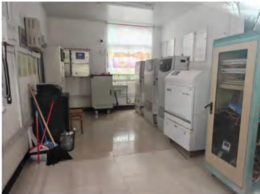
图 4.1-5 废水在线监控设施
