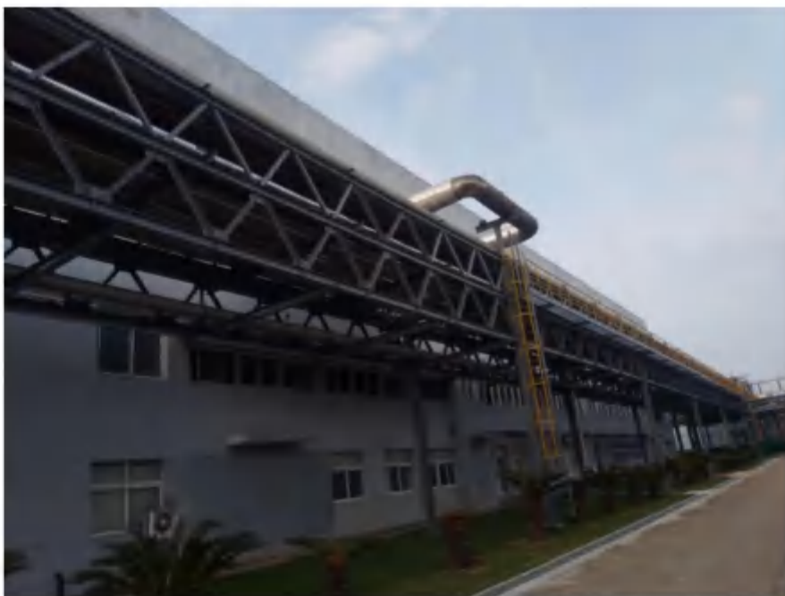
图 4.5-1 厂区架空管廊设置
